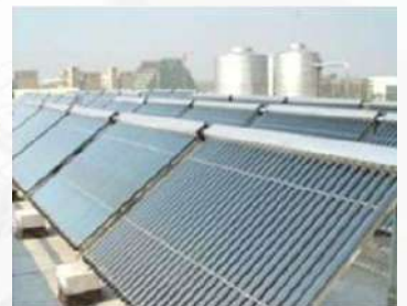
Coletores de tubos de vacuo
