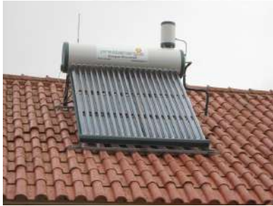
Sistema de termosifão
